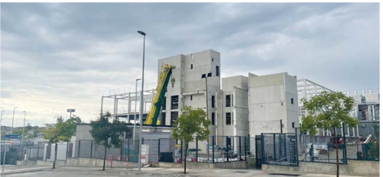
Data Center para Equinix en Alcobendas, Madrid (España)
