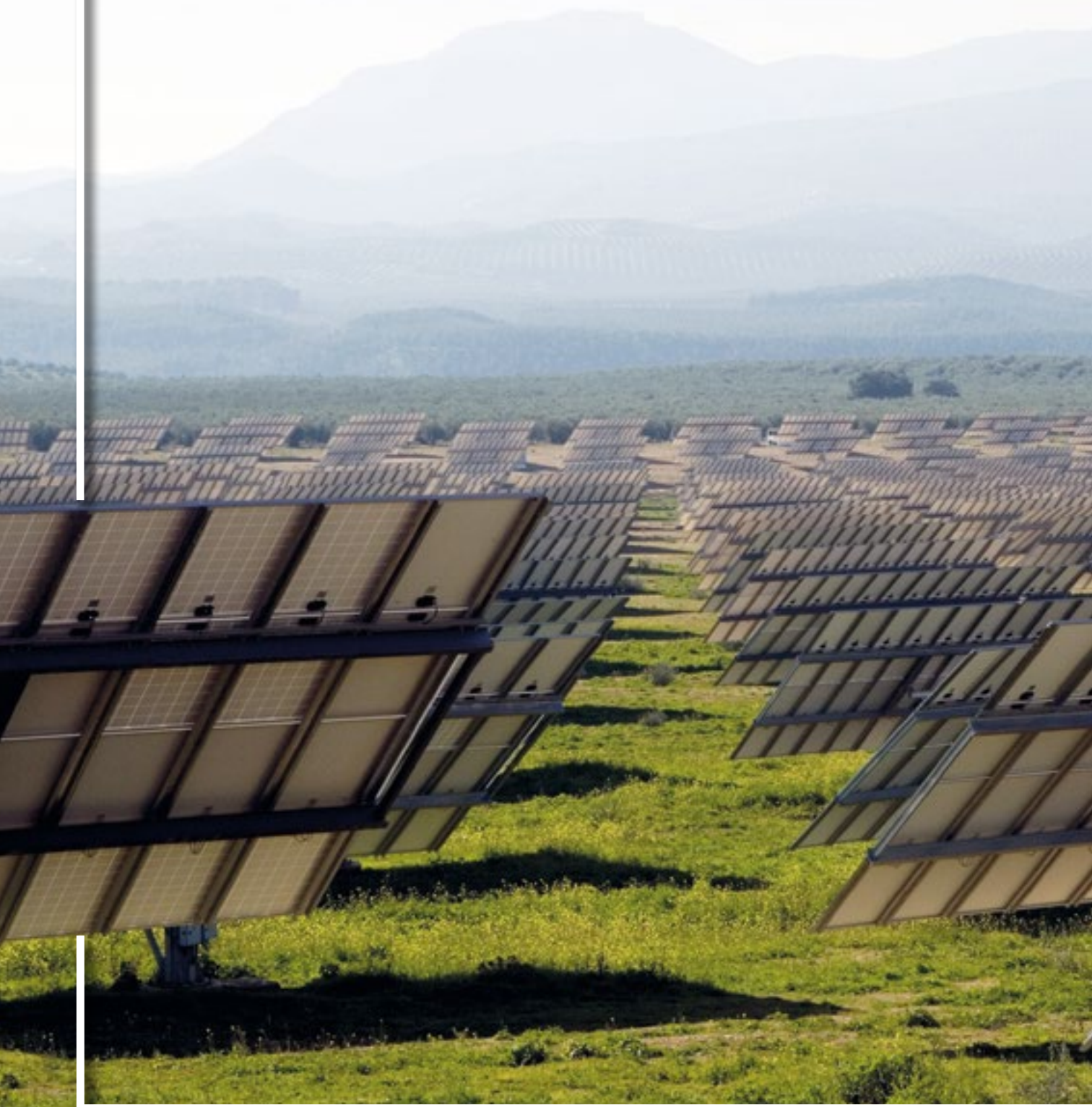
Planta fotovoltaica de 5,4 MW en Alcaudete, Jaén
