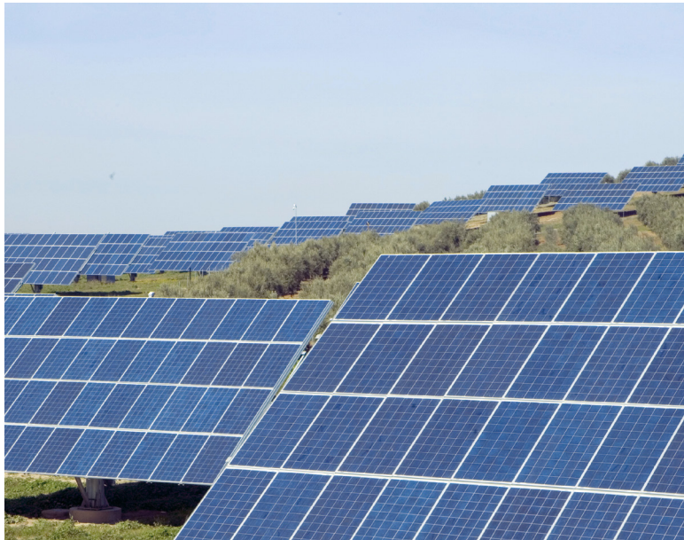
Planta Fotovoltaica de 5,4 MW en Alcaudete, Jaén (España)
